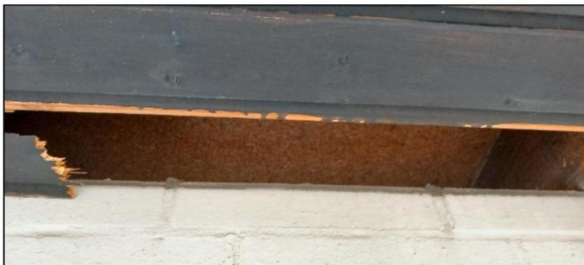
Abbildung 5: Spalte an einer Dachkante.
