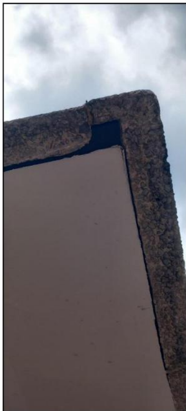
Abbildung 28: Hohlraum zwischen Fassadenplatte und Gebäudewand.
