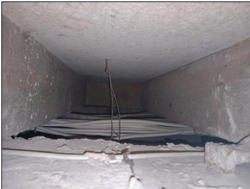
Abbildung 7: Weiterer leerer Kabelschacht an der Dachkante (s. Abb. 5).
