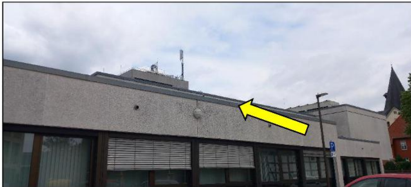
Abbildung 36: Bleche über den Fassadenplatten (gelber Pfeil).
