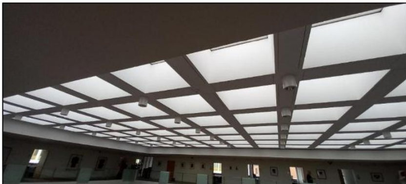
Abbildung 13: Intakte Oberlichter im Foyer.
