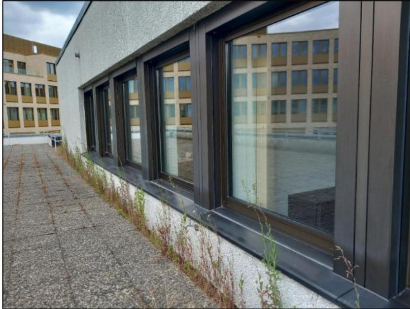
Abbildung 25: Intakte Fenster im Bereich der Dachterrasse. Es konnten keine Kotspuren von Vögeln oder Fledermäusen festgestellt werden.
