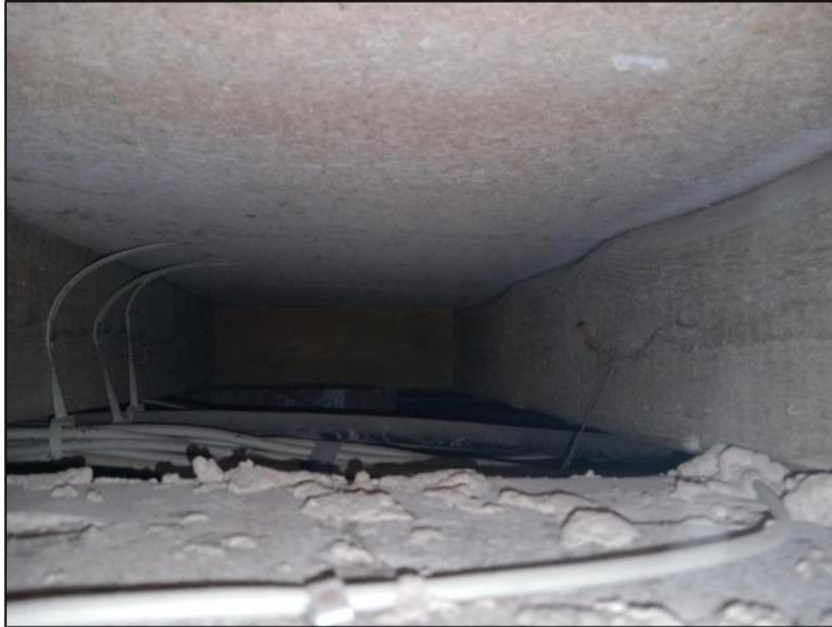
Abbildung 6: Leerer Kabelschacht an der Dachkante (s. Abb. 5).
