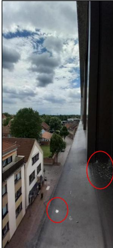
Abbildung 18: Fensterbänke von außen mit Spuren von Vogelkot (Rot).
