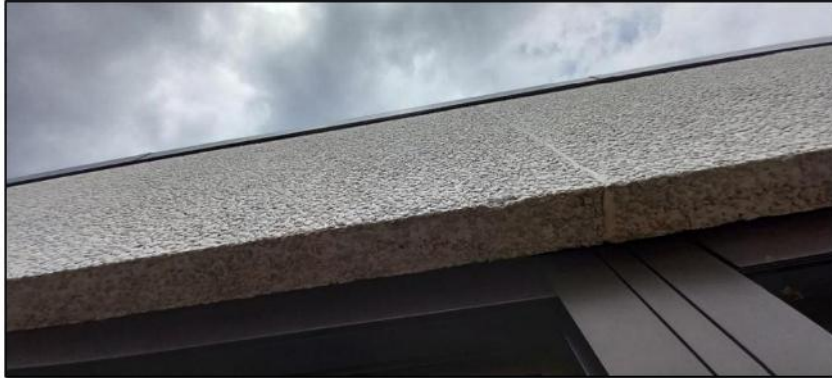
Abbildung 27: Weiterer Bereich zwischen Fenster und Fassadenplatte.
