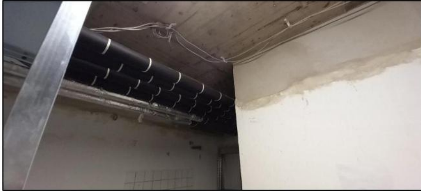
Abbildung 21: Rohrleitungen im Bereich der Kellerdecke. Es konnten keine Nester von Brutvögeln festgestellt werden.
