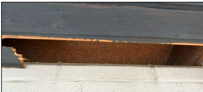
Abbildung 5: Spalte an einer Dachkante.
