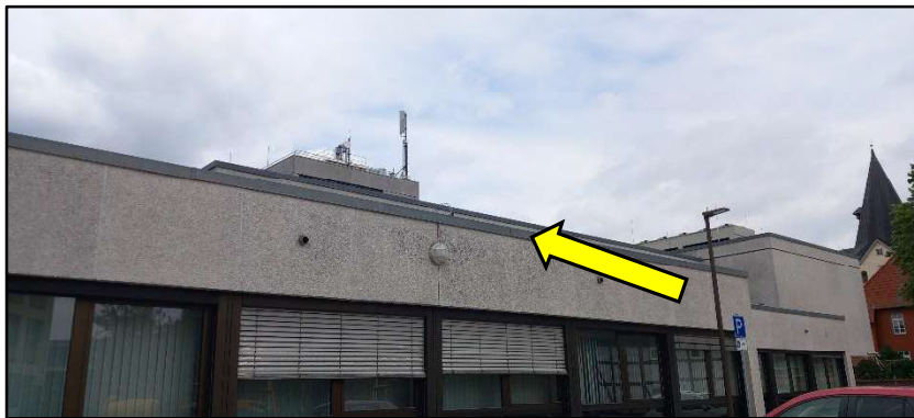
Abbildung 36: Bleche über den Fassadenplatten (gelber Pfeil).
