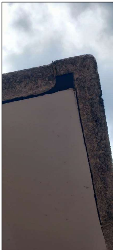
Abbildung 28: Hohlraum zwischen Fassadenplatte und Gebäudewand.
