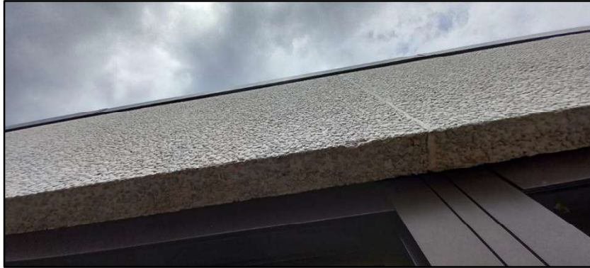
Abbildung 27: Weiterer Bereich zwischen Fenster und Fassadenplatte.
