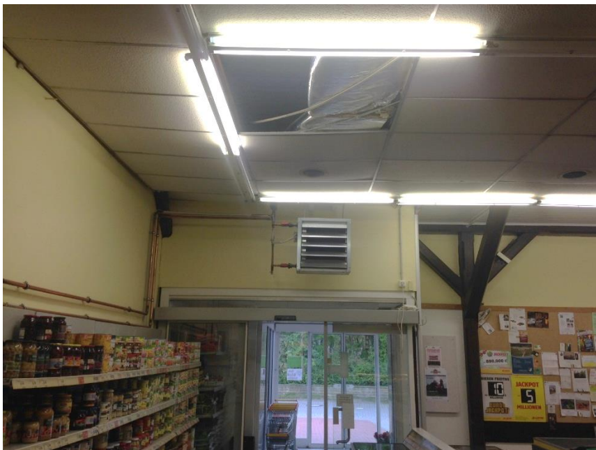
Defekte Decke des Dorfladens
